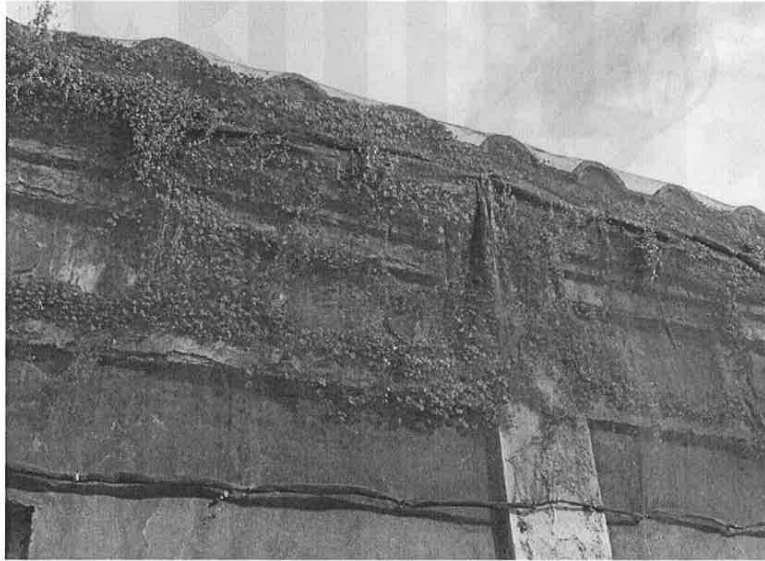
Estado de degradación (15/02/2021). Colonización de plantas y consecuente degradación de la cubierta
