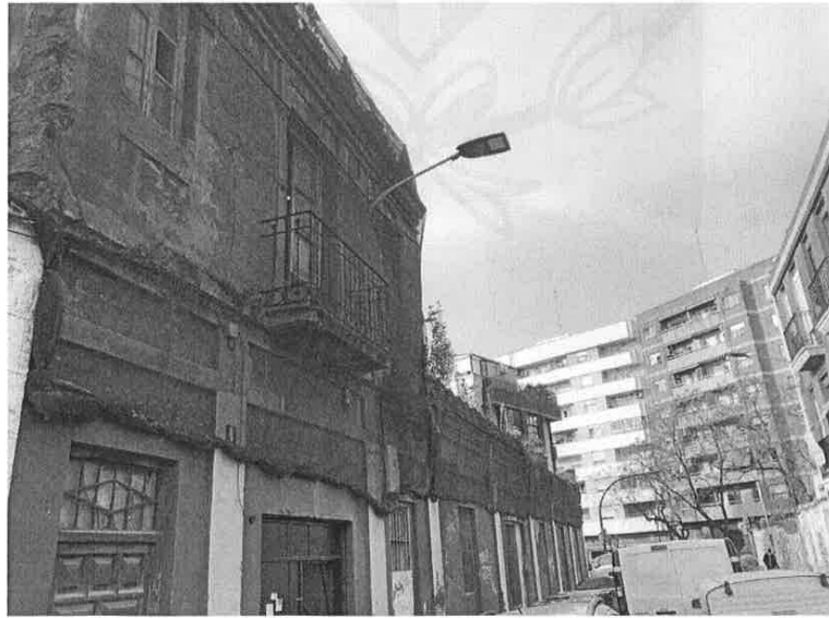
Estado de degradación (15/02/2021)
