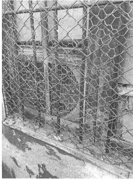
Estado de degradación (15/02/2021). Se observa aparato de aire acondicionado colocado por el personal que actualmente ocupa el inmueble
