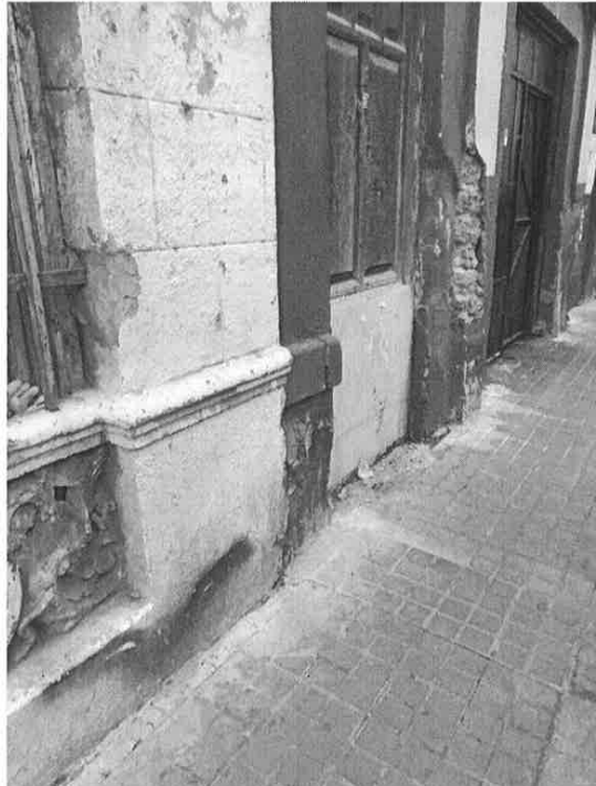
Estado de degradación (15/02/2021). Se observa puerta metálica negra colocada por el personal que actualmente ocupa el inmueble
