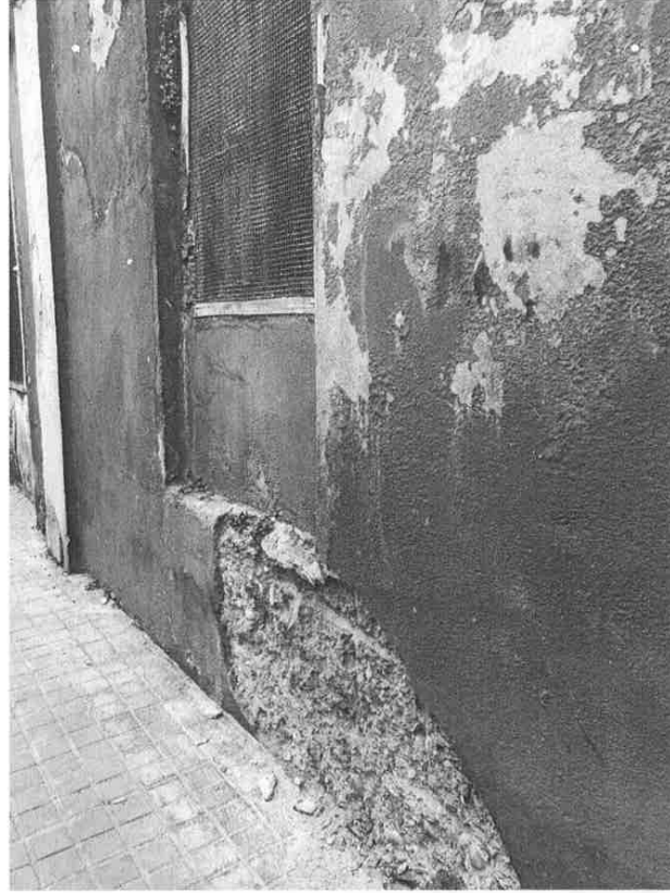
Estado de degradación (15/02/2021).
