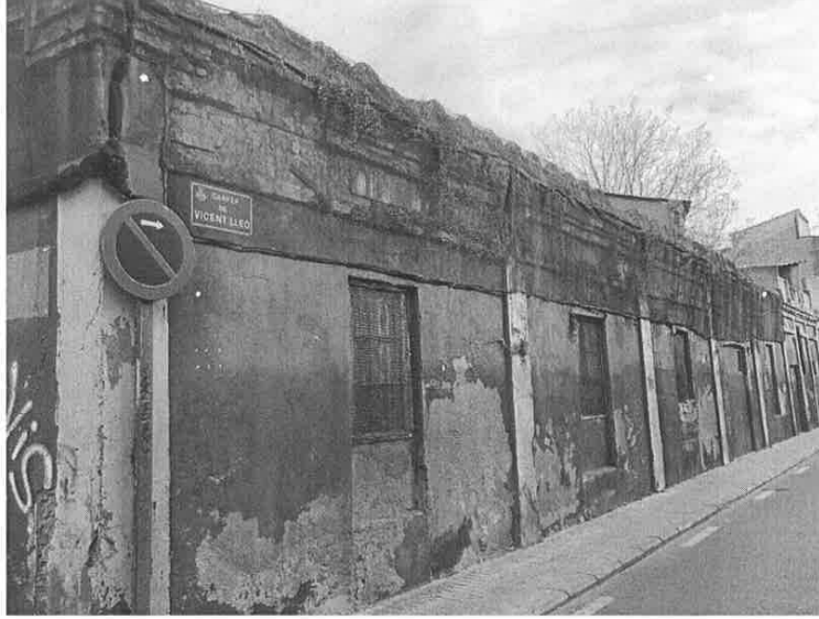
Estado de degradación (15/02/2021)
