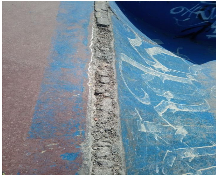
1.2---ZONA PATINAJE SKATE. JARDIN DEL TURIA FRENTE IGLESIA MONTEOLIVETE. FOTO.- PROBLEMAS DETECTADOS.-BORDILLOS de LA INSTALACION DETERIORADOS Y FALTA MANTENIMIENTO.
